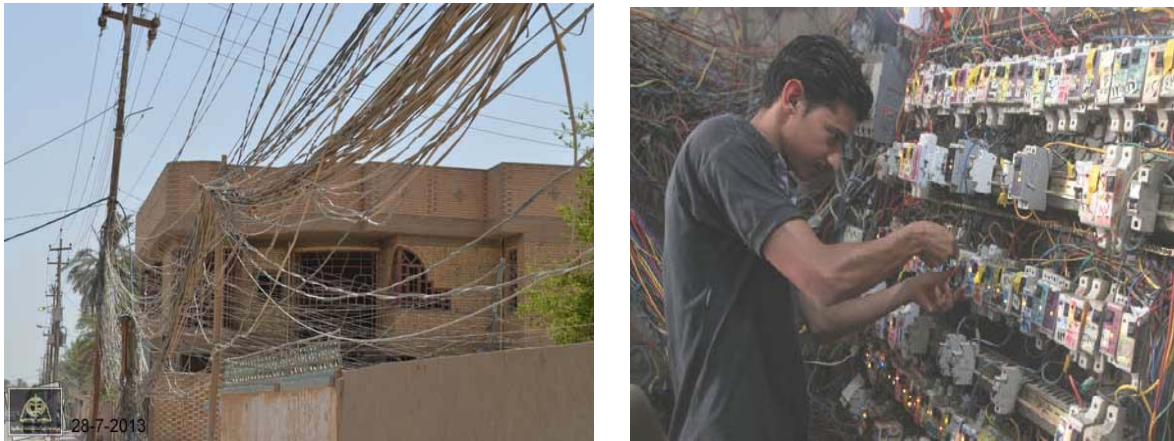
Fig. 54 : Un enchevêtrement de câbles électriques quadrille les rues, reliant les maisons aux générateurs privés, témoignage de l'incapacité du gouvernement à fournir le courant en continu Source : photos personnelles de l'auteur.
