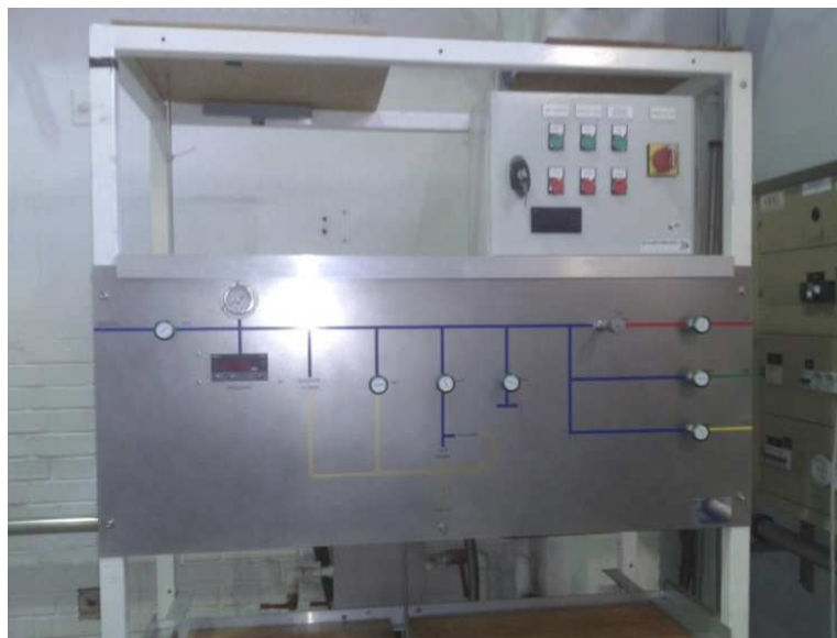
FIGURE 2.10 – tableau de vannes SOPHIE
