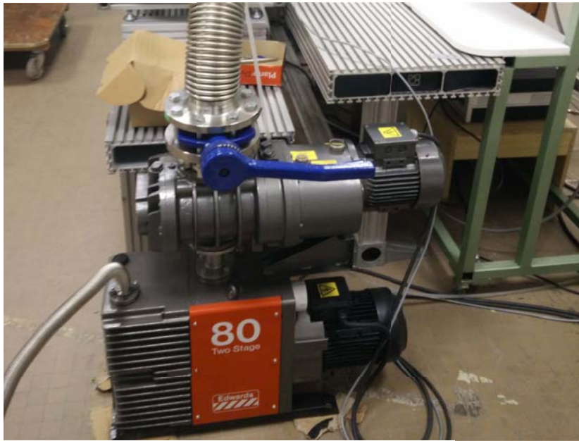
FIGURE 2.9 – Les deux pompes à vide et leur évacuation.
