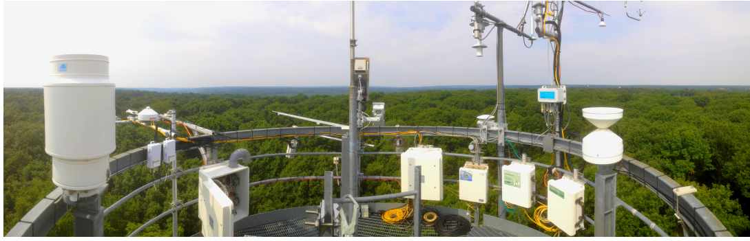
Fig. 20 : Photo des installations situées sur la tour à flux de Barbeau.
