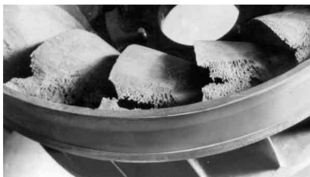
FIG. 1.18 – Erosion de cavitation sur une roue de turbine Francis
