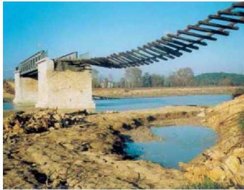
PhotoII.7 Remblai de la voie ferrée emporté par la crue de l'Aude à Sallèles d'Aude (Source : EGIS Eau, rapport AZI DREAL LR)
