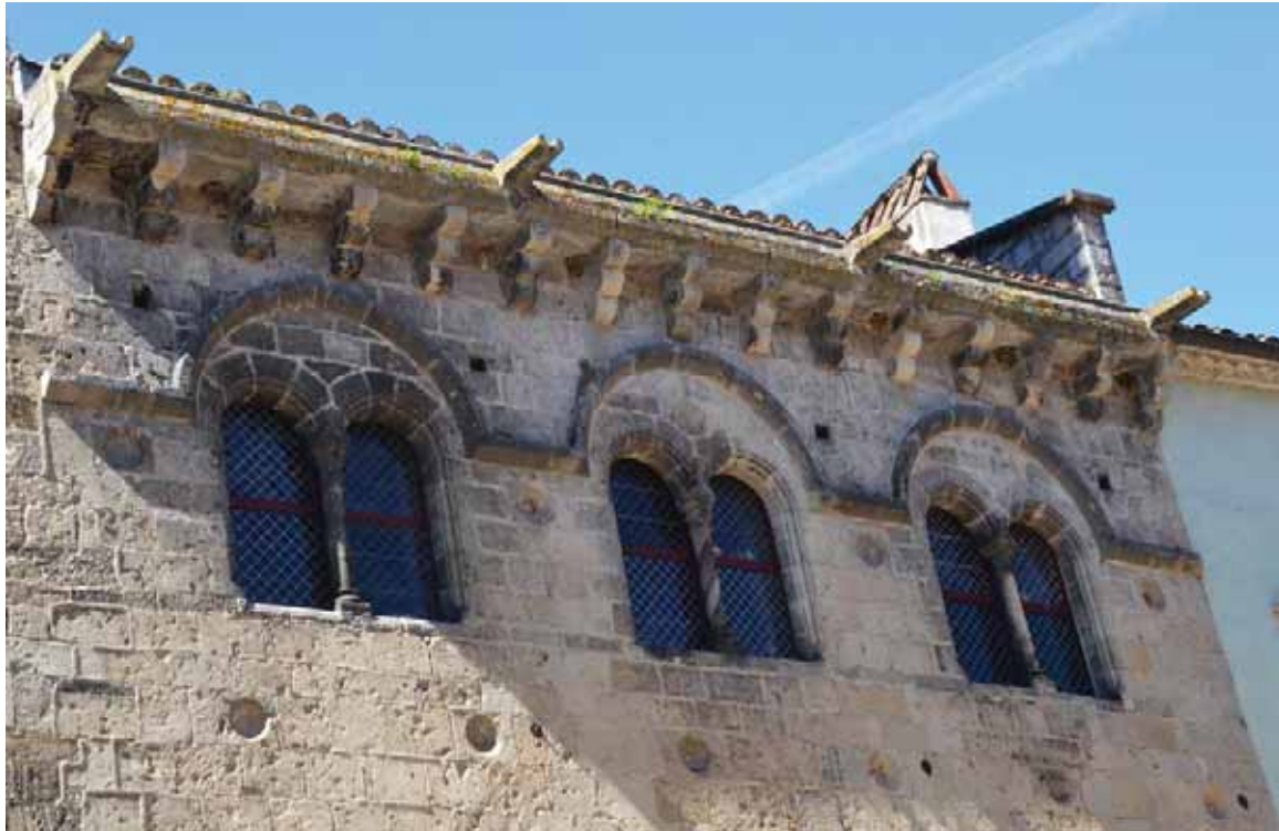
système d'évacuation des eaux de toiture de la maison romane ID 4, place de la Halle
