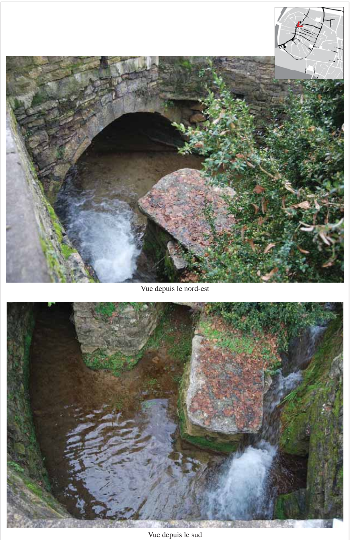
Fig. 411 : réunion de plusieurs canaux secondaires dans le canal de la dérivation inférieure
