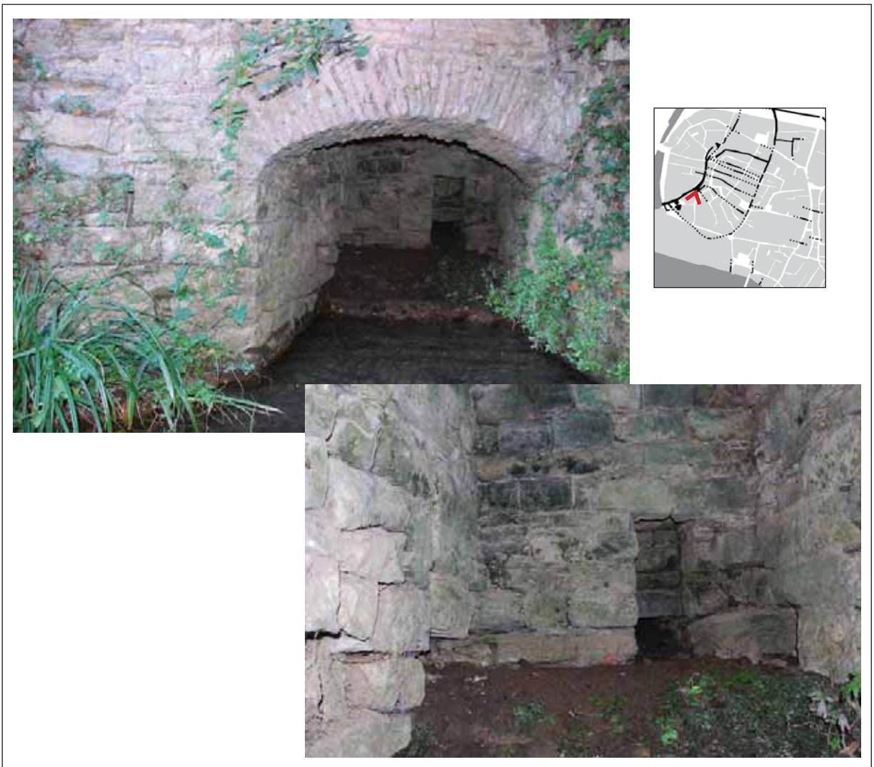
Fig. 432 : collecteur de canaux secondaires débouchant dans la dérivation inférieure
