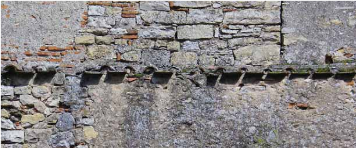
Vestiges de la toiture d'origine en tegulae et imbrices de la maison ID2
