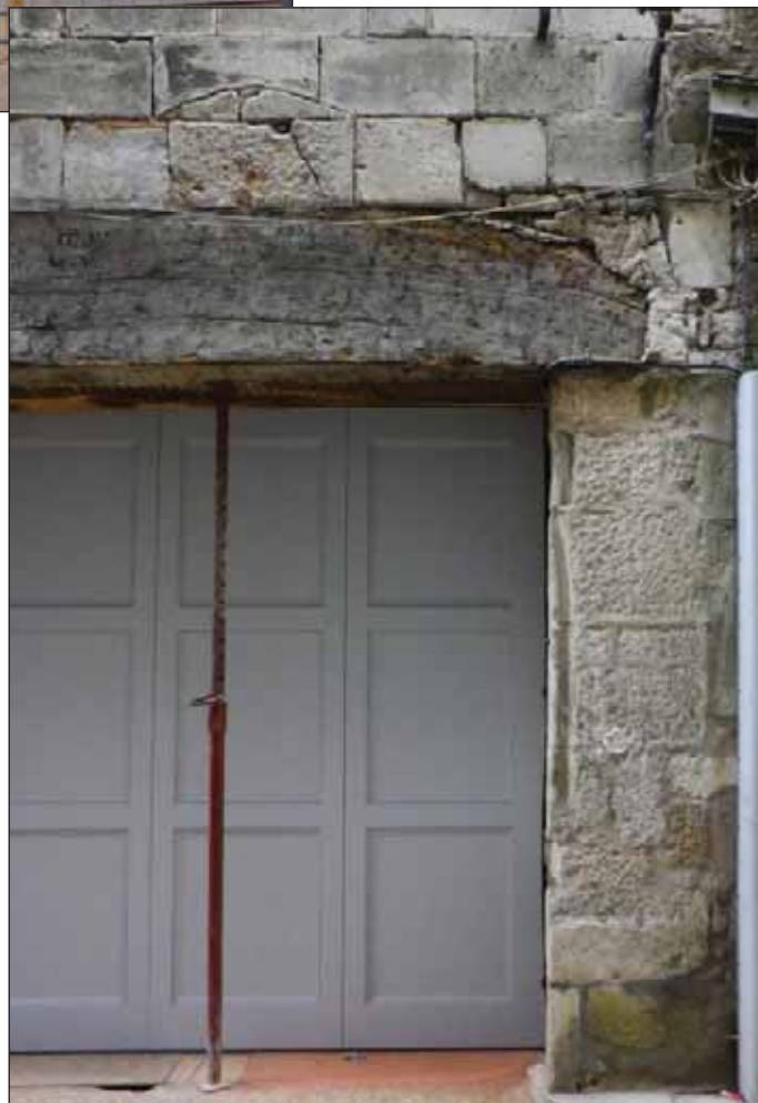
Fig. 4 : piédroit et négatif de la grande arcade de droite au rez-de-chaussée sur la rue de la Pélisserie
