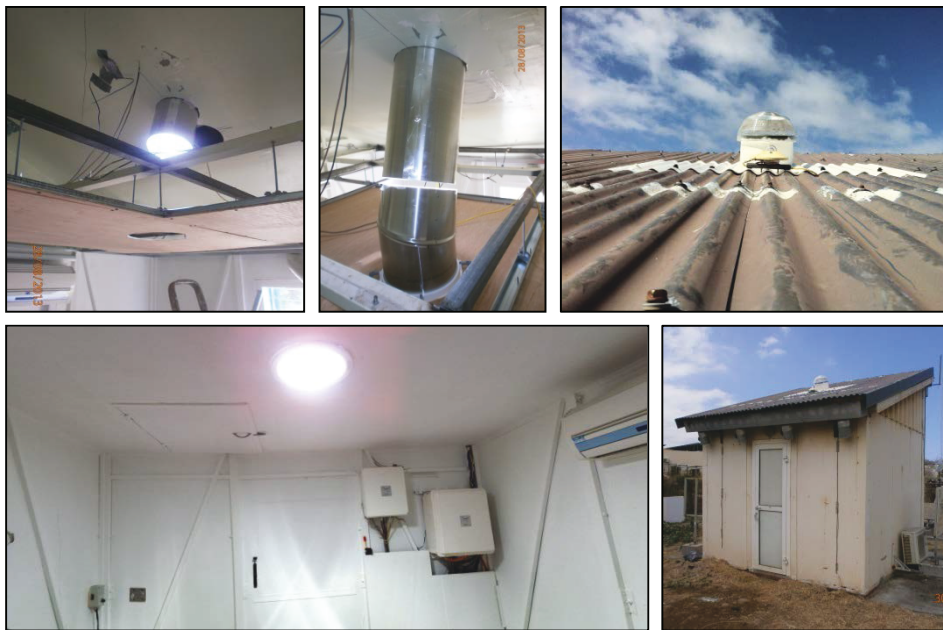
Figure 55 : Modification de la cellule LGI
