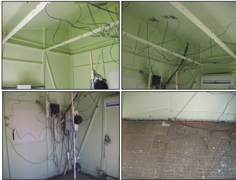
Figure 53 : Cellule LGI - Vues intérieures avant modification (Guichard 2013)
