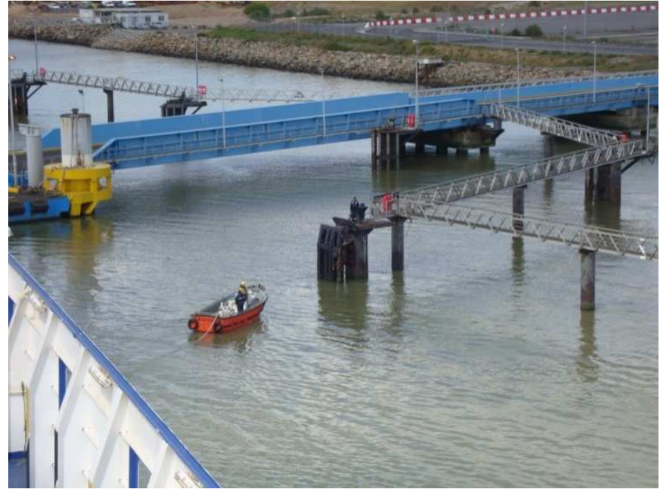
Equipements destinés à l'amarrage
