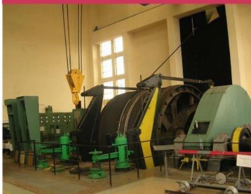
Salle de la machine d'extraction.
