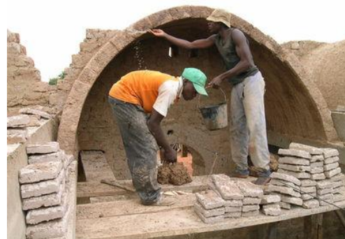
Fig. 14 : Construction d'une voûte nubienne sans coffrages bois. Source : Association la voûte Nubienne. http://www.lavoutenubienne.org/fr/ma%C3%A7ons-%C3%A0- (consulté en juin 2013).
