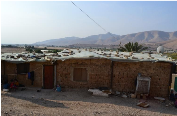
Fig.131 : Façade nord de la maison Jiftlik 2 sans enduit, les briques d'adobe sont apparentes. Nous remarquons aussi la fragilité de la toiture. (Photo : Rania Daher, 2013)
