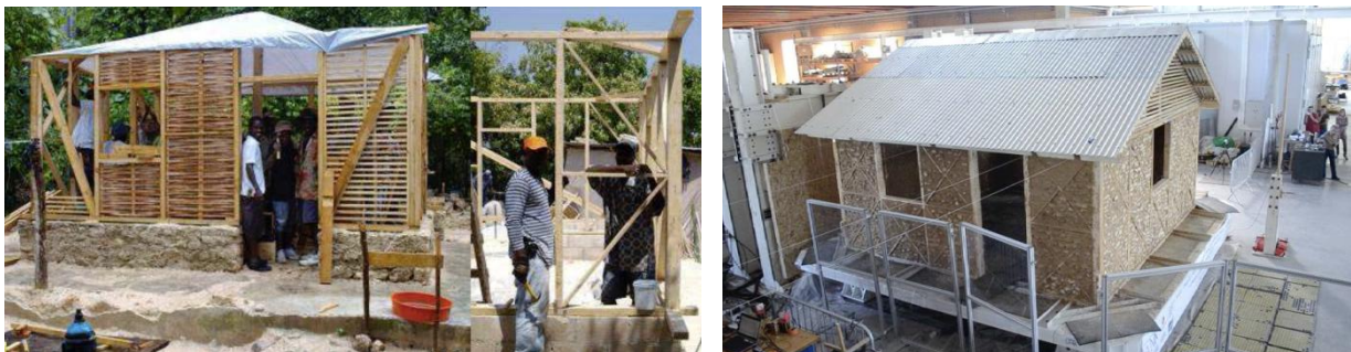
Fig. 23 et 24 : Prototypes proposés par le CRATerre pour la reconstruction d'Haïti. Deux typologies sont développées. Les murs à ossature bois sont remplis soit en pierre (à droite) soit en terre crue (à gauche). (Garnier et al, 2014).
