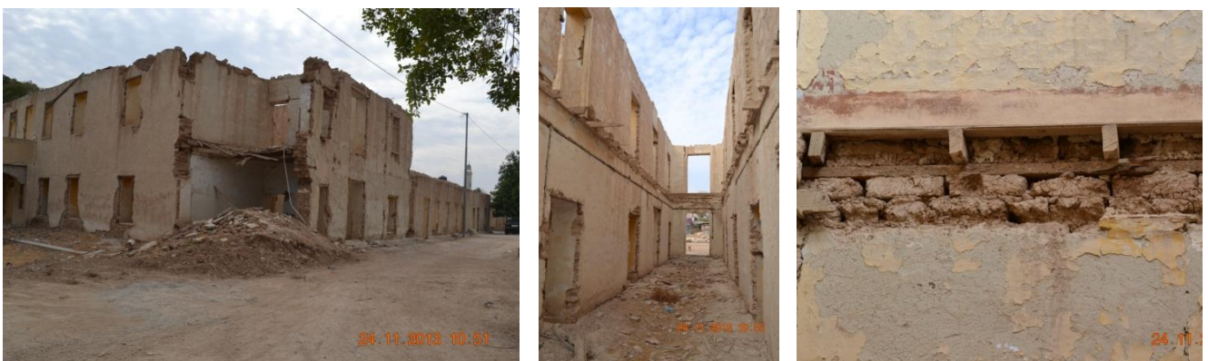
Fig. 103, 104 et 105 : L'ancien palais hivernal à Jéricho. Patrimoine récent en adobe. A droite, plancher type en bois de la construction. (Photo : Rania Daher, 2013).
