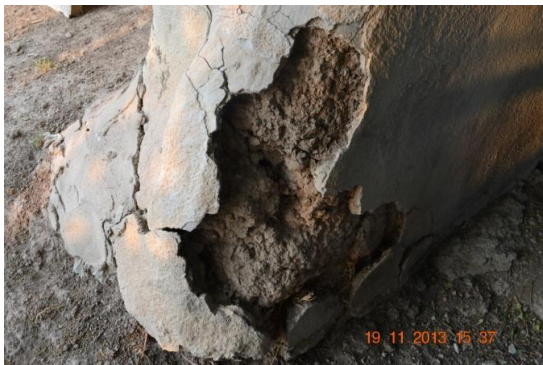
Fig. 65 : Enduit en ciment de la maison Jiftlik 5 (Photo : Rania Daher, 2013).
