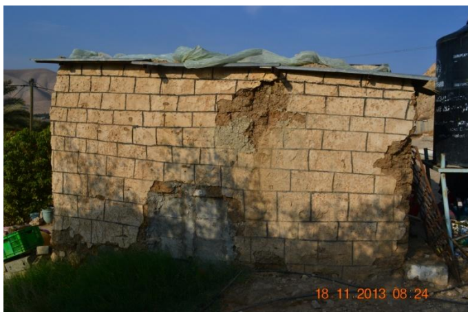
Fig. 135 : Façade est de la maison Jiftlik 2, au niveau des sanitaires. Les murs en adobe ont été affaiblis par une mauvaise intégration des conduits d'eau. (Photo : Rania Daher, 2013)
