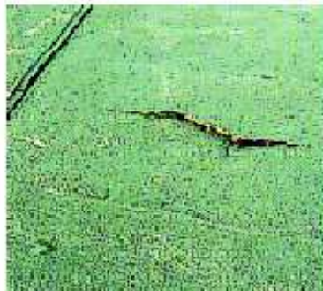
FIGURE 2.6: Déchirement de la membrane de l'isolant suite à un écrasement local [57].
