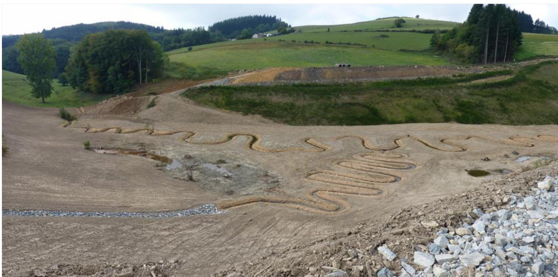
Fig. 89 : Travaux de restauration écologique aux abords de l'A89 (Source : Audal, Epures, 2013c)
