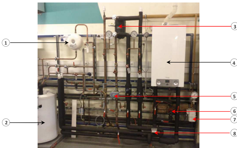
Fig. III.5 - Perspective du banc d'essai au laboratoire Climatherm (1 : vase d'expansion, 2 : ballon tampon, 3 : échangeur de chaleur, 4 : micro cogénérateur, 5 : vanne 2 voies au secondaire, 6 : pompe primaire supplémentaire, 7 : débitmètre gaz, 8 : vanne 3 voies).
