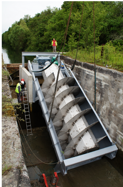
FIGURE 1.22 – Installation d'une PCH à vis d'Archimède sur le canal du Rhône au Rhin - Source : www.elleo.fr
