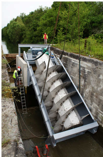
FIGURE 1.22 – Installation d'une PCH à vis d'Archimède sur le canal du Rhône au Rhin - Source : www.elleo.fr
