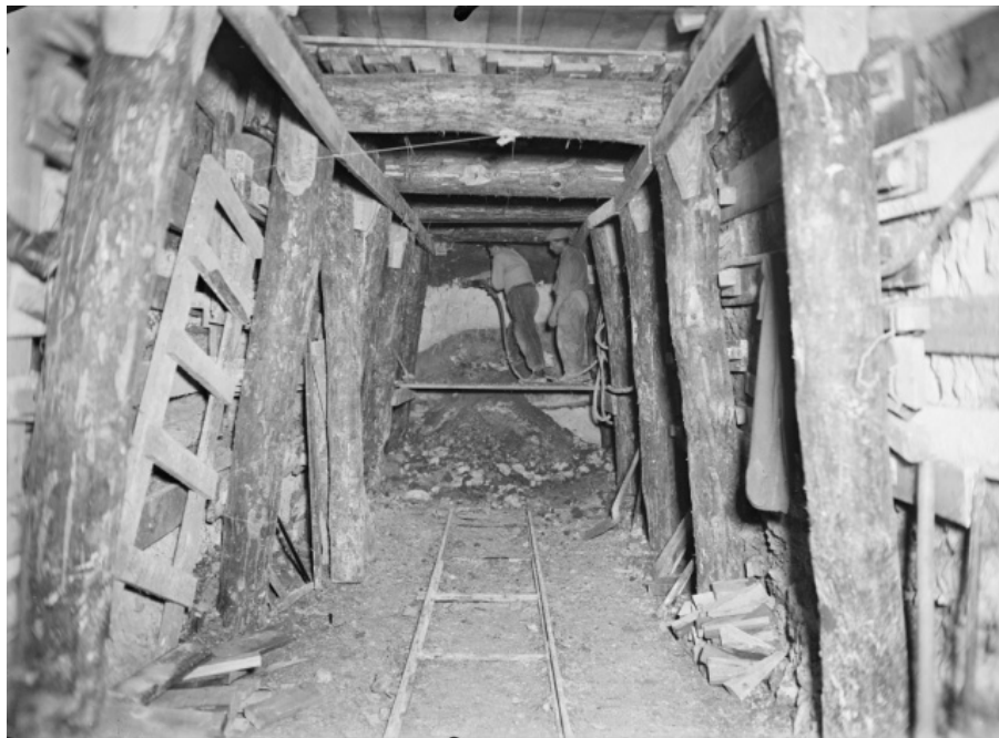
Figure 1.11 Première phase – Galerie d’avancement lors de la création du raccordement des lignes 4 et 12 du métro à Montparnasse en 1934 ©RATP
