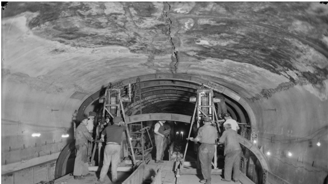
Figure 1.26 Fissuration en clé de voûte. Photo : travaux de renforcement du tunnel vers la station Obligado de la ligne 1 (aujourd'hui Argentine) en 1946. ©RATP.
