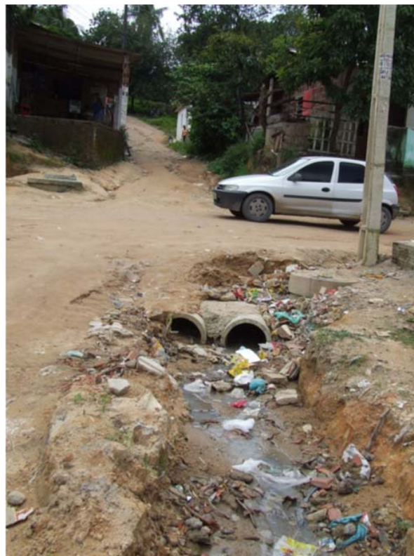
Photo 2-8 : Eaux usées et ordures déversées à ciel ouvert
