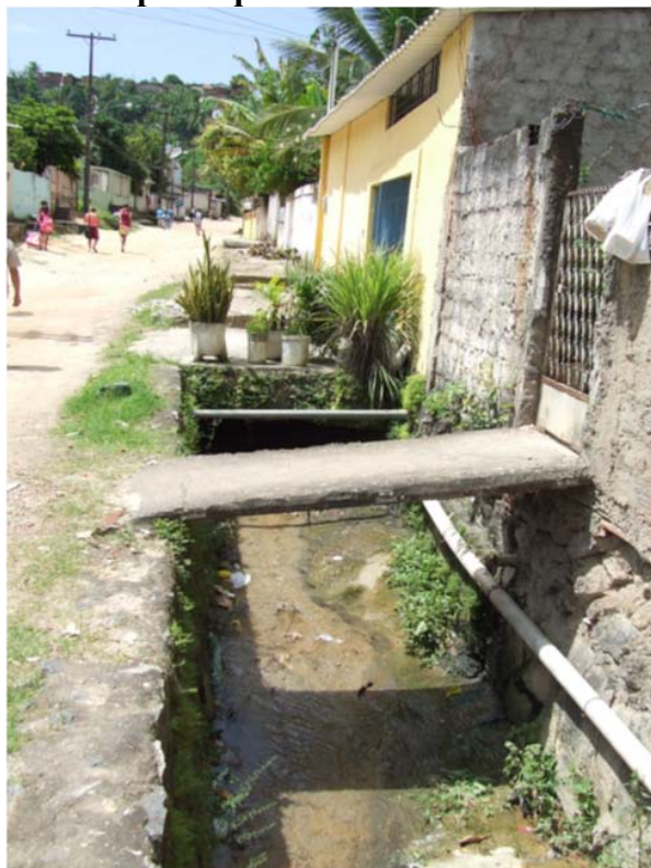
Photo 2-7 : Branchement irrégulier provoque une fuite d'eau
