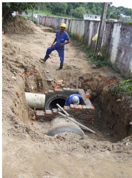
Photo 4-4 : Le réseau public d'assainissement dans Passarinho
