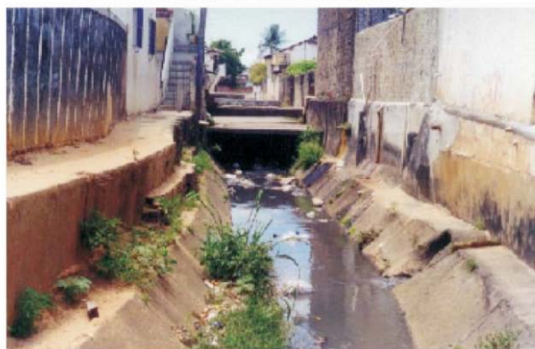
Canal de drainage (eaux pluviales et eaux usées)
