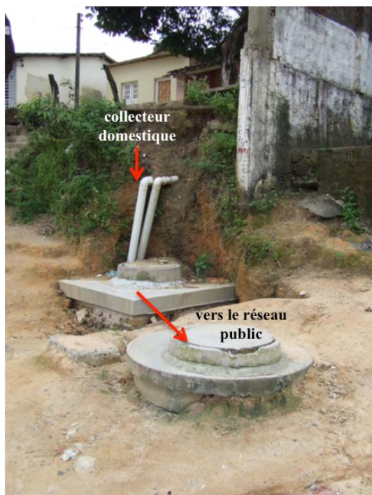
Photo 4-3 : Le réseau domestique d'assainissement dans Passarinho
