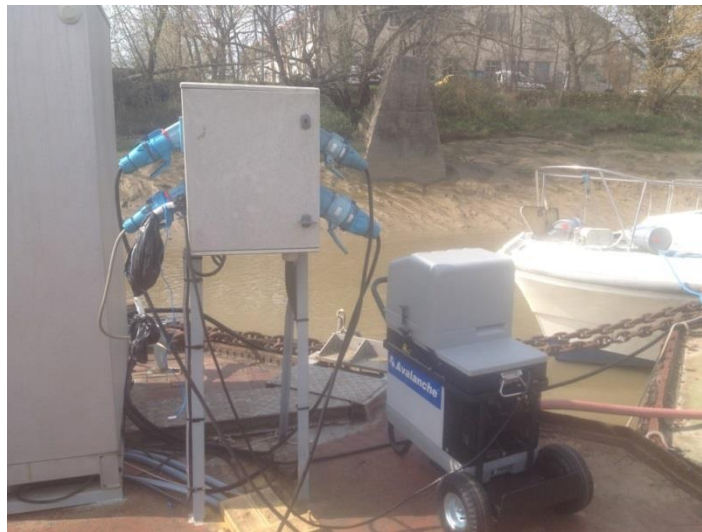
Figure 32. Echantillonnage par préleveur automatique au site de Bordeaux
