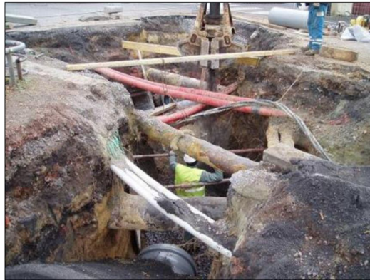
FIGURE 2.8: Un sous-sol encombré en zone urbaine dense, source [Boesch, 2014]
