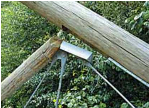
(a) Rupture d'assemblage
