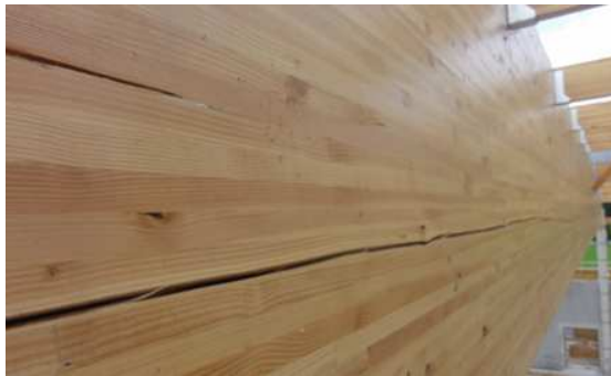
(a) Fissuration en partie courante
