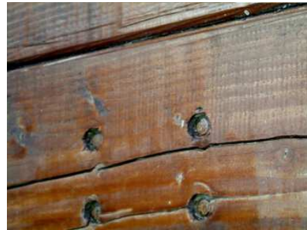
(b) Fissuration au droit d'un assemblages
