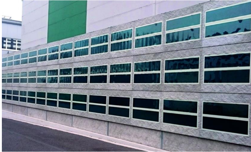
Figure IV.5. Premier mur solaire à Herne (Allemagne) réalisé avec des panneaux OPV par les entreprises Heliatek et Reckli
