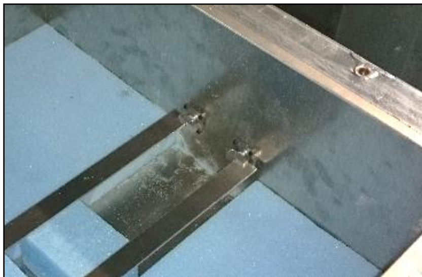
Figure 64: Connexion du busbar aux connecteurs N.
