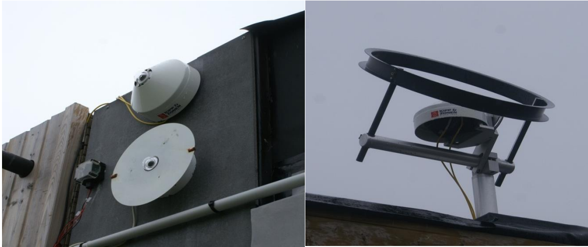
Figure 43 : A gauche : pyranomètre vertical global et capteur de luminosité destiné au pilotage du volet ; A droite : pyranomètre équipé de la bande pare-soleil
