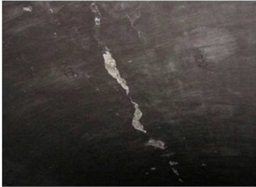
Figure 1-36 : Fissuration en clé de voûte (Goirand, 2012)
