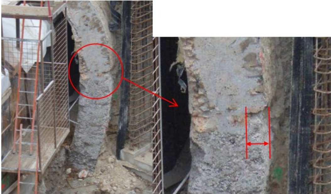
Figure 1-31 : Défaut de clavage entre voûte et piédroit (Goirand, 2012)
