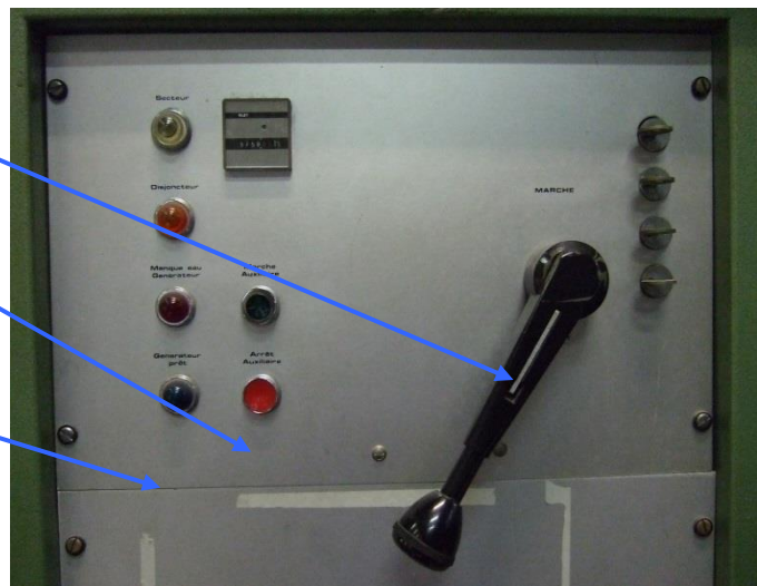
Figure C3.1 - Commande du générateur placé sur l'armoire
