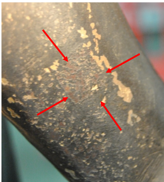
Figure IV 1.3-33 : Justice. Vue de détail d'une plaquette de réparation au niveau de l'avant bras droit. A noter également que par endroit la patine s'écaille © C2RMF, M Castelle
