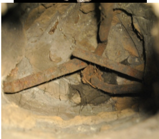
Figure IV 1.3-5 : Justice. En haut : Vue de la base (diamètre 30 cm). On aperçoit les extrémités des armatures du réseau principal. En bas : Vue intérieure depuis l'ouverture. Le fond correspond à la base du cou bouchée par du noyau. 4 armatures visibles: 2 qui courent sur toute la hauteur de la statue (section carrée chanfreinée 10 mm) et 2 plates (10 mm) pour les bras (flèches rouges). © C2RMF A Maigret, M Castelle
