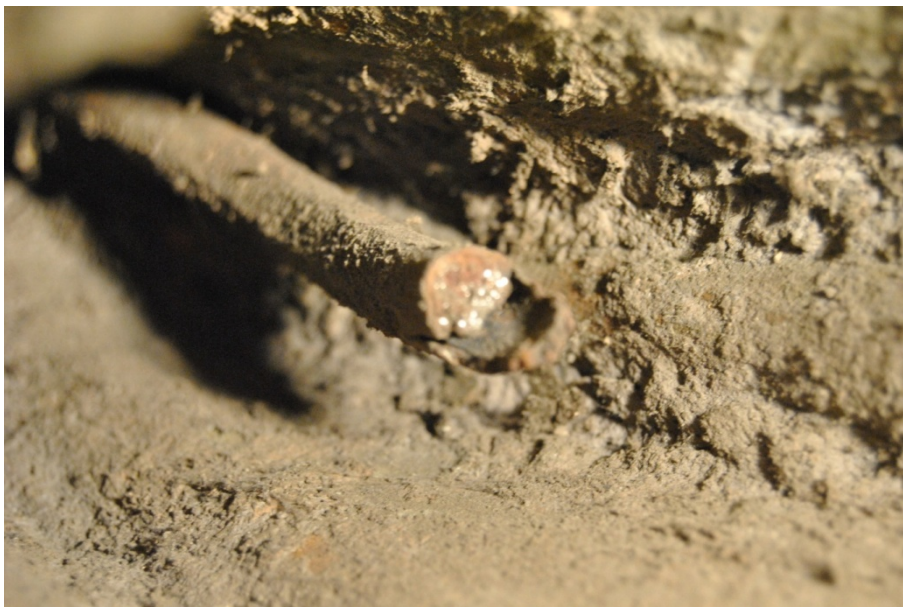
Figure IV 1.3-14 : Justice. Vue de l'intérieur non loin de la base. Détail de l'extrémité d'une des deux armatures principales (celle qui passe par le côté gauche de la statue) au niveau de la base. Les armatures principales présentent une section carrée chanfreinée (10 mm). A son extrémité l'armature présentée par la photo n'a pas été coupée de manière nette. Remarquer la surface interne de la statue ayant imprimé la granulométrie et les fibres végétales du noyau. © C2RMF, M Castelle
