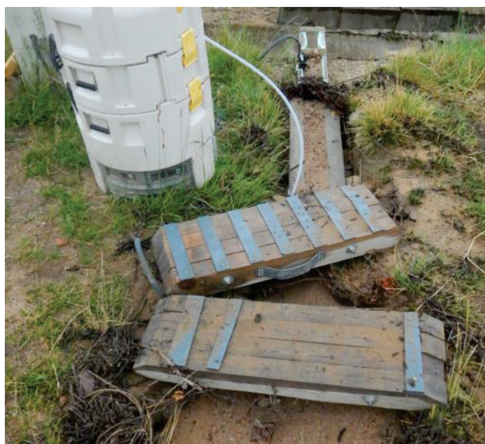
Figure 37 : photographie du dispositif de suivi du ruissellement après un événement pluvieux très érosif : on constate un remplissage du canal
