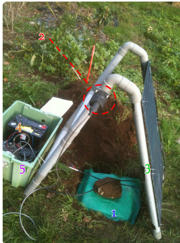
Figure III.1-10 – Installation d'une station sismologique, exemple de la station NENO : 1 - le capteur (NoeMax) avant d'être recouvert ; 2 - l'antenne G.P.S. ; 3 - les panneaux solaires ; 4 - la batterie ; 5 - le système d'acquisition (DAS Osiris).
