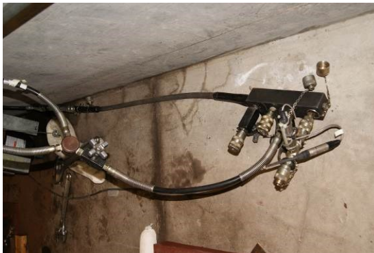
4. Multiplicateur hydraulique et valve hydraulique de contrôle des vérins
