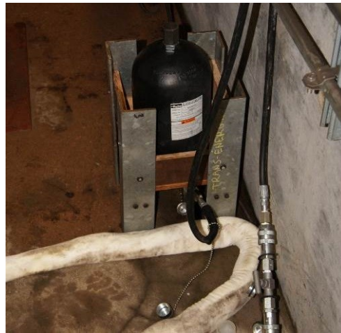
3. Accumulateur Parker 6600 psi et valve hydraulique VH1
