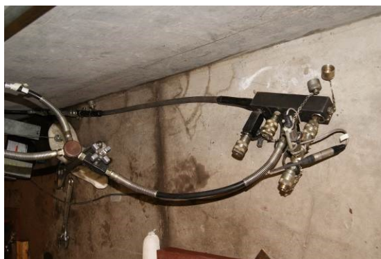
Multiplicateur hydraulique et valve hydraulique de contrôle des vérins (Subdivision 4)
