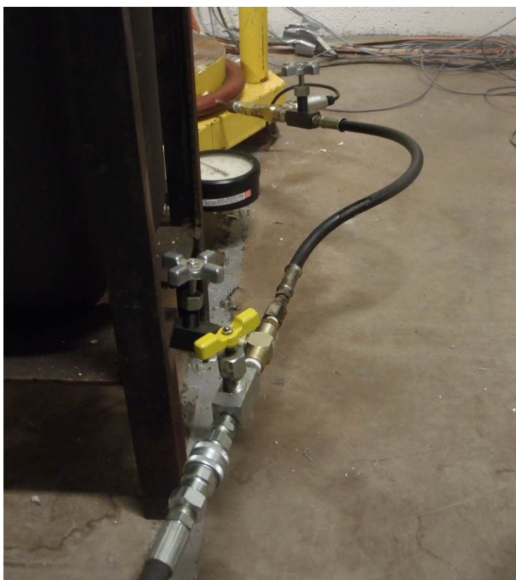
Figure D-17 : De bas en haut, valve VH1 (en jaune), valve de sécurité de l'accumulateur, valve VH2, et capteur de pression hydraulique
