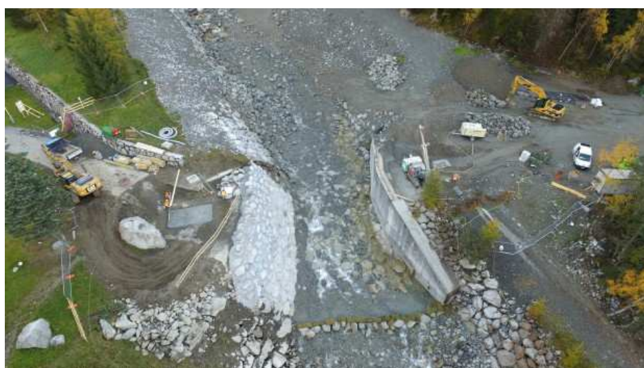
Annexe 9 : Les travaux d'élargissement de la plage de dépôt du tunnel sur le torrent de la Creusaz, source : ATMB
