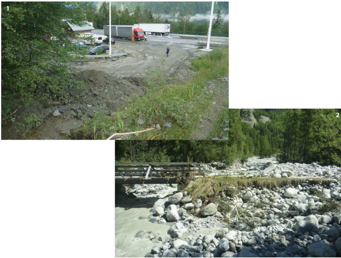
Annexe 6.1 Conséquences des crues d'août 2014 : (1) le débordement en rive droite du torrent de la Creusaz près de la douane ; (2) la passerelle qui a obstrué le cours de l'Arveyron d'Argentière, occasionnant une diffluence en rive droite.
