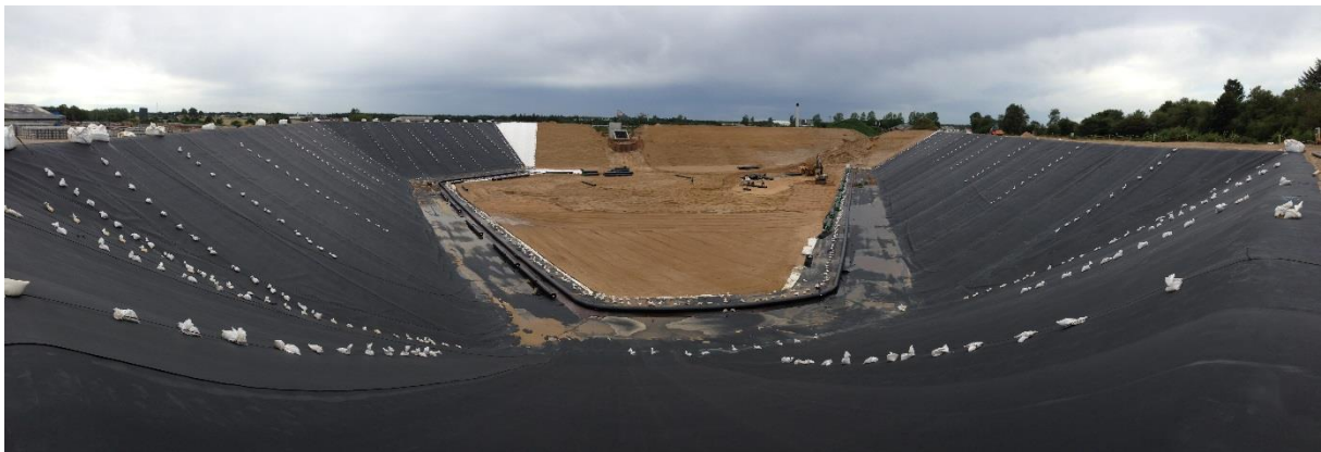
Figure 9 : PTES (200 000 m 3 ) de Vojens, au Danemark. ©GSE Lining Technology GmbH.
