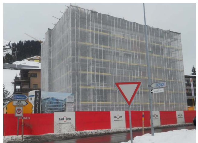
Photographie C.II : Construction d'un immeuble collectif par un promoteur privé à Davos Dorf. Prix d'appel pour un T 3 : 891 000 euros. L. Piquerey, janvier 2013.
