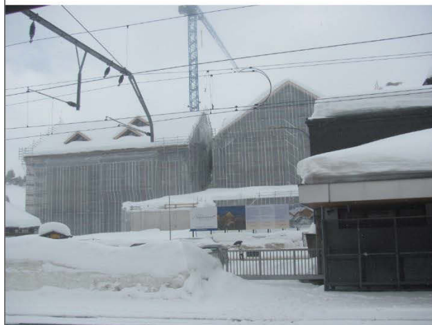
Vue sur le chantier de construction de l'hôtel cinq étoiles superior « The Chedi », Andermatt, Uri. L. Piquerey, mars 2011.
