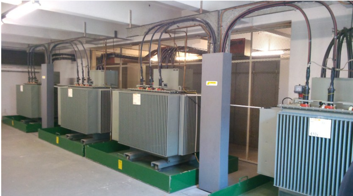
Figure 6-2 : le local HTA et ses 4 transformateurs d'alimentation
