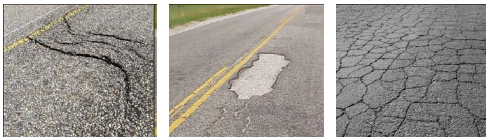
Figure I. 20 : Dégradations relatives à des défauts de collage (Asphalt Technology News, 2015)
