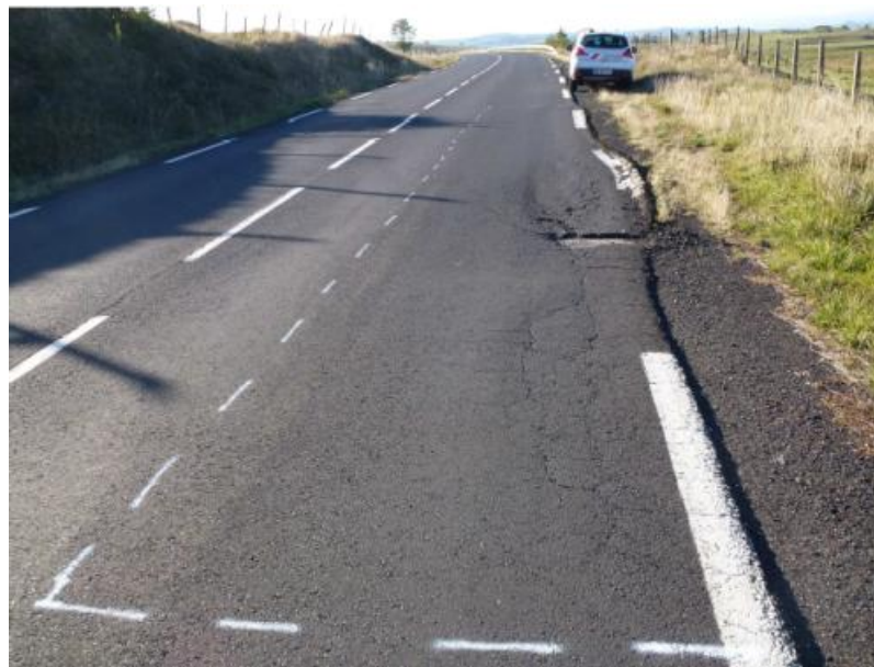
Figure 1 : Dégradations et défauts de collage d'interface (RD3, Cantal, France)
