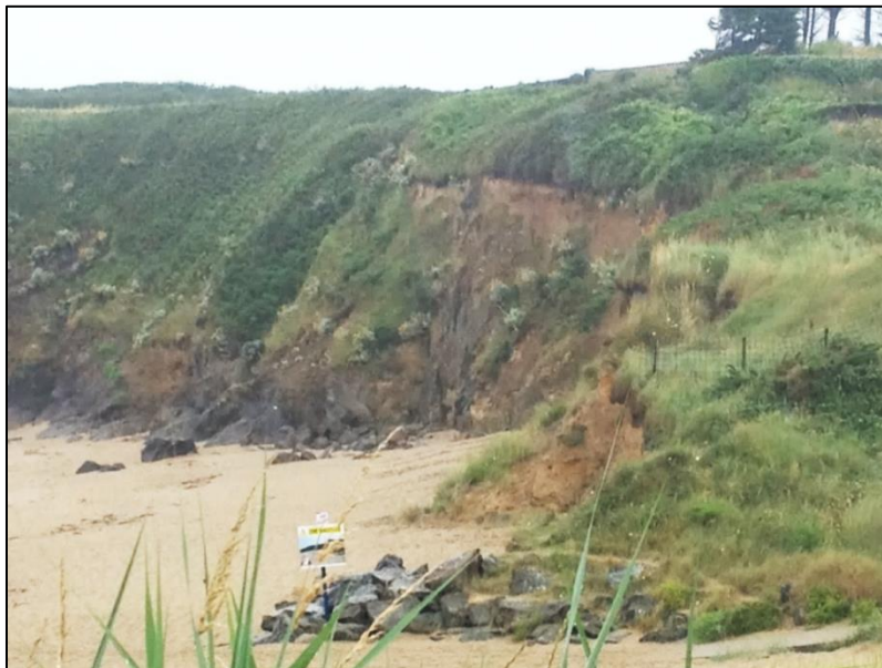
Figure 53 : enrochement de falaise meuble de la plage de la Mare partie Est, falaise meuble <10 m de hauteur végétations basses (pelouses) , 2015.
