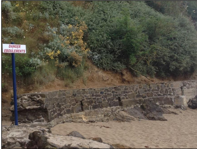
Figure 201 : plage de la Mare mur de protection
