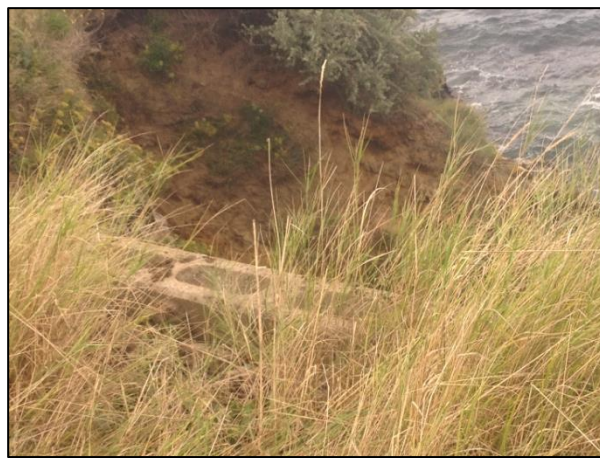
Figure 43 : falaise meuble « aménagée » par un pylône.
