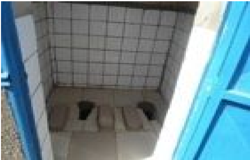
Photo 12 : L'intérieur de latrines propres et à doubles fosses
