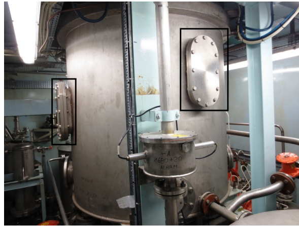
FIGURE 5.6 – Brides en acier sur la cuve du réacteur.
