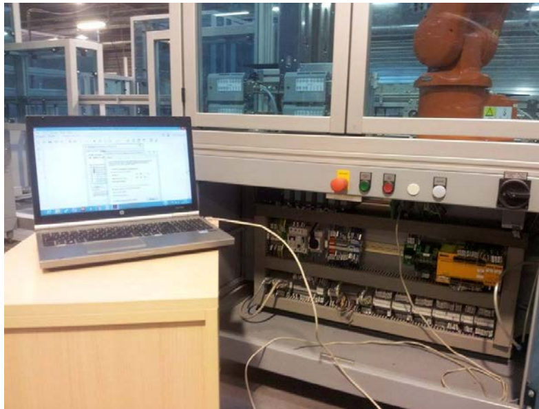
Figure 4.11- Branchement entre le PC et l'automate
