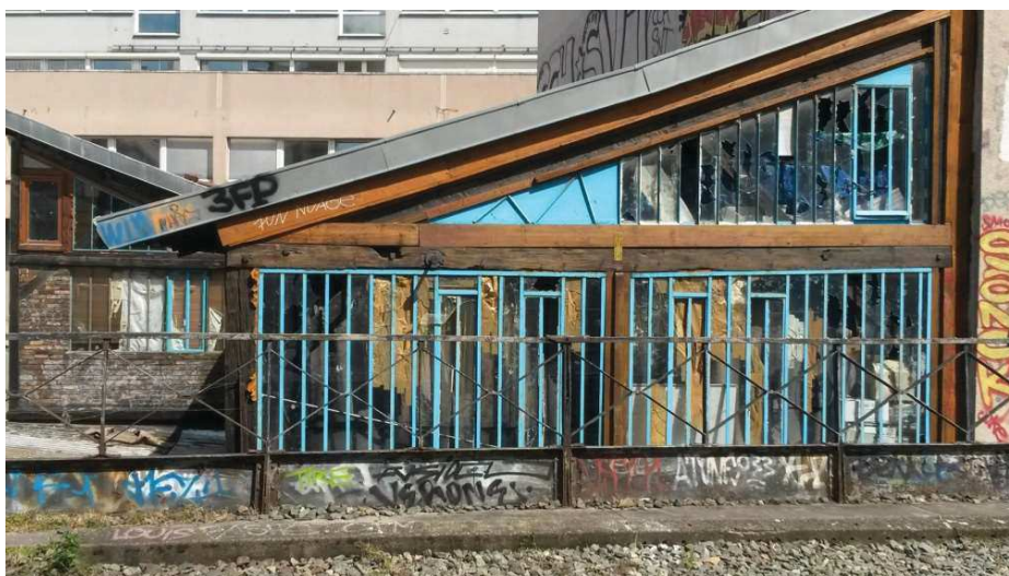
Photo 55 : Bâtiment aux vitres brisées, le long de la voie dans le XX e . Photo personnelle, avril 2014.
