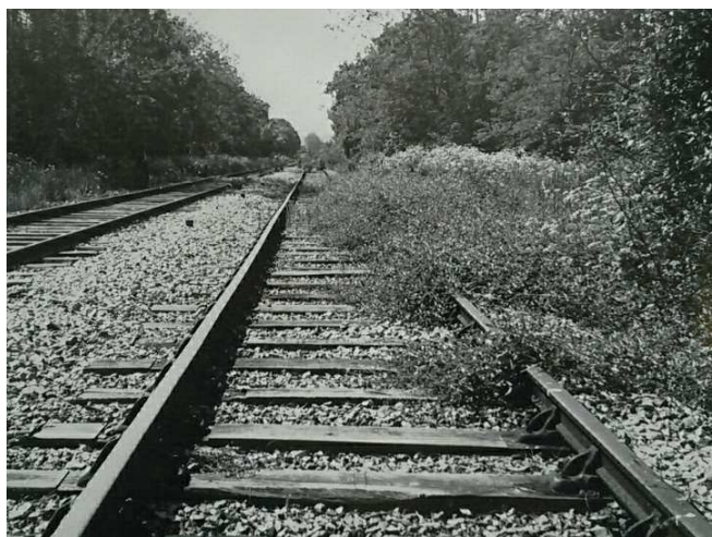
Photo 10 : Entre les anciennes stations de Grenelle et de Vaugirard dans le XV e , 1980 (Pitrou et al. 1982).
