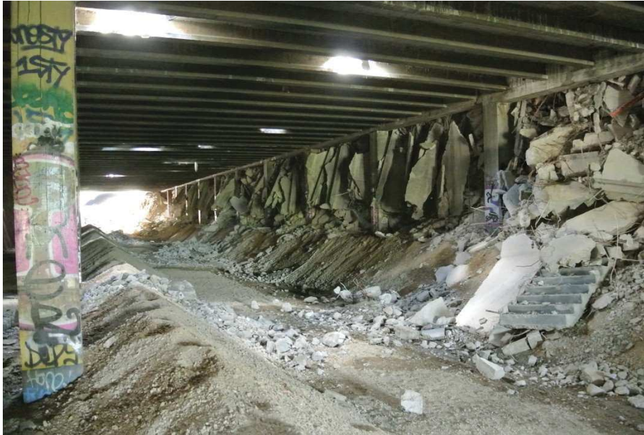
Photo 37 : Les anciens quais de la gare de Montrouge lors de la destruction de la dalle. Photo personnelle, août 2014.
