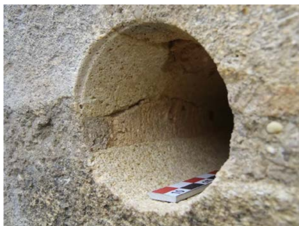
Figure VII-12 : Carottage à l'extérieur de la chapelle de la Rose de la basilique Saint Seurin (détail).
