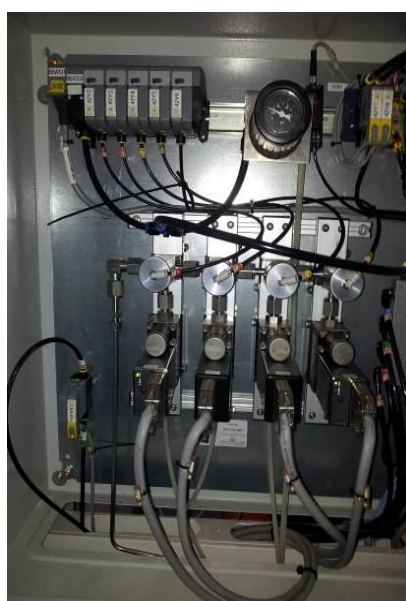
Figure I.4. Photo des circuits de contrôle de l'injection des gaz.
