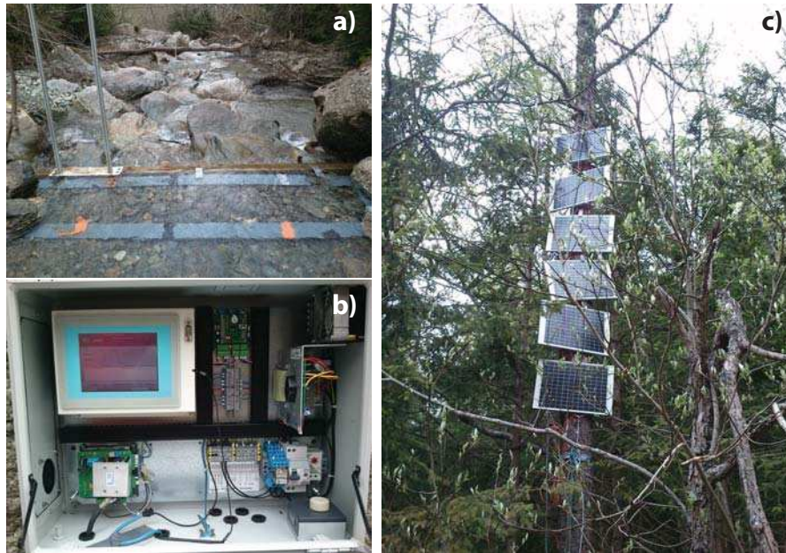
FIGURE 4.10 – Appareillage statique pour le suivi des galets marqués par PIT. a) Antenne fixe installée dans le lit du torrent des Bossons à la sortie du Plan des Eaux; b) Intérieur de la centrale d'acquisition de l'antenne RFID statique; c) installation des panneaux solaires permettant de recharger les batteries.
