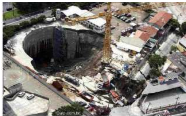
Figure 6 : Exemple de l'effondrement d'un tunnel en cours de construction, Station de métro à Sao Paulo en 2007.
