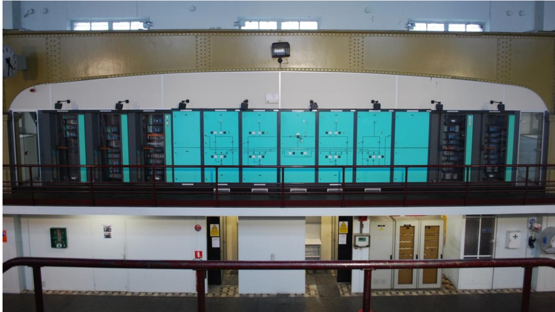
Figure 89 : Tableau électrique de l'usine de Cusset en 2014 (collection personnelle)
