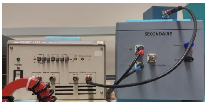
Figure 77 : Amplificateur de puissance et transformateur d'alimentation de rapport 4,5
