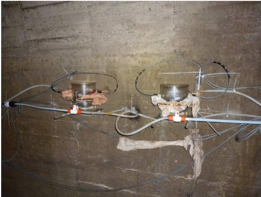
FIGURE A.2 – Photographie de deux pots appartenant chacun à une extrémité des inclinomètres LB1. On voit que le pots reposent sur des plaques en verre soutenues par des tiges de silice, qui traversent la paroi bétonnée du bunker.
