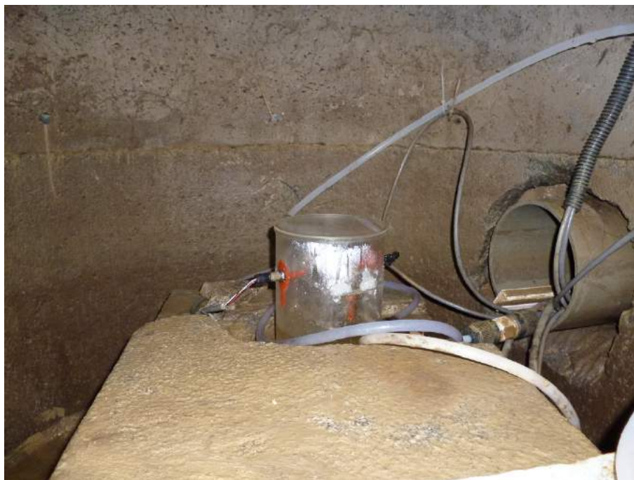
FIGURE A.6 – Photographie du pot Ouest de l'inclinomètre LB2. Il est posé sur une dalle de granite qui est ancré dans le sol. Cette configuration est identique pour les deux autres pots de l'instrument.
