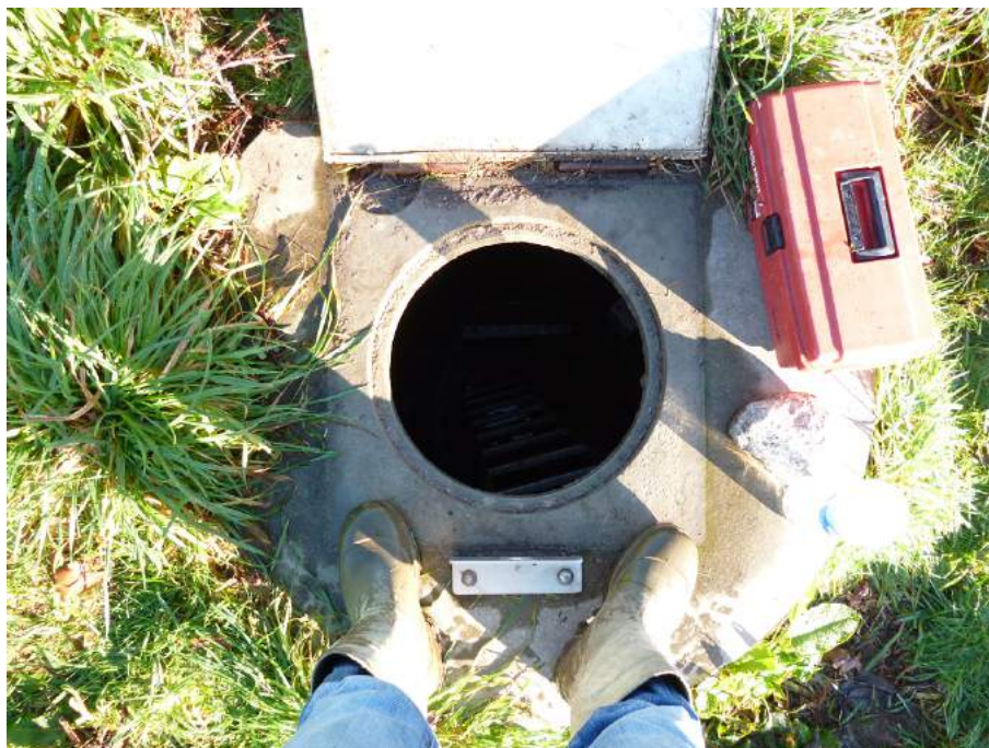
FIGURE A.5 – Photographie d'une buse d'accès à un pot de l'inclinomètre LB2.
